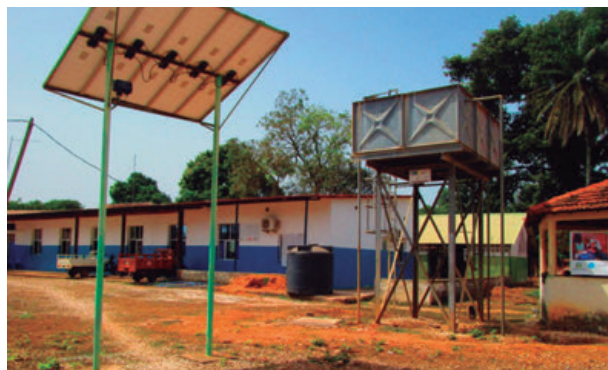
Pozo Hospital Regional Marcelino Banca con su depósito y paneles solares. Al fondo de la foto ala obstétrica del hospital.
